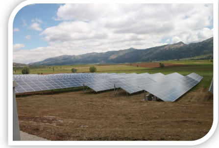
Foto 2. Güneş Enerji Santrali
